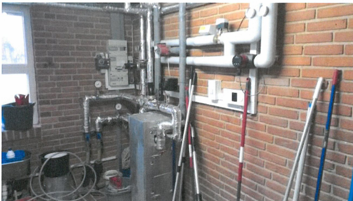
Varme- og brugsvandsanlæg, gl. hal.jpg
