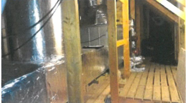
Ventilationsanlæg, gl. hal.jpg
