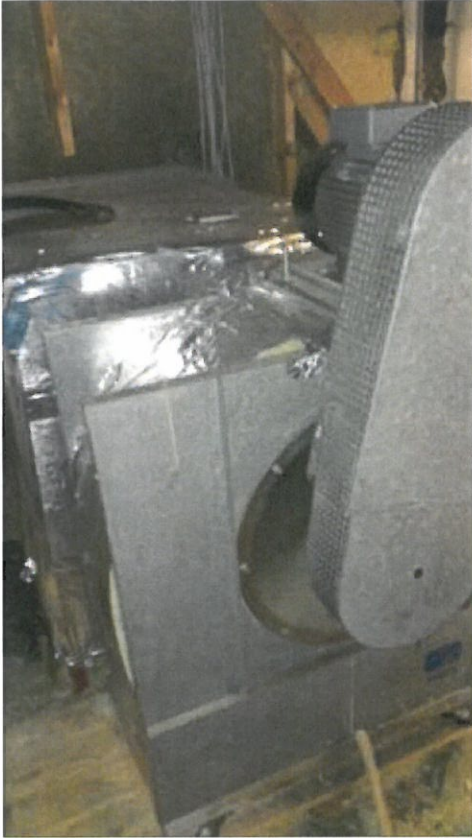
Udsugningsventilator, gl. hal.jpg
