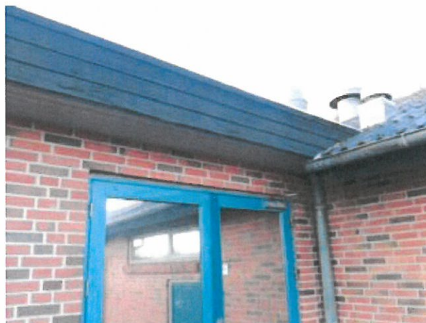
Sternbrædder med revner og slidt overflade
