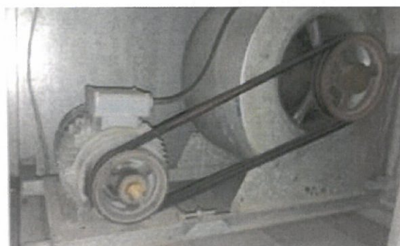
Indblæsningsventilator, gl. hal.jpg
