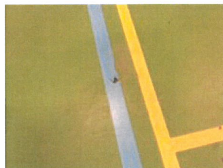
Skade i gulv
