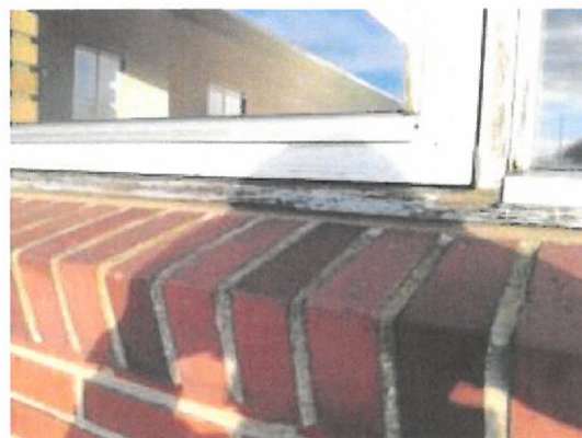
Vindue med råd i bundkarm
