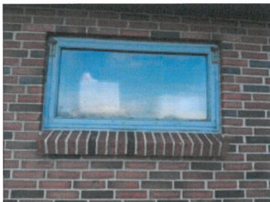
Vindue med slidt overflade
