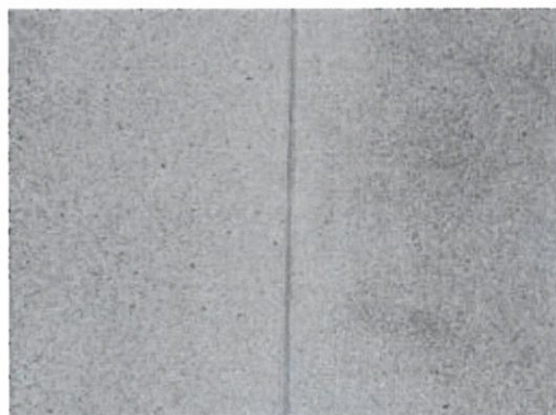
Dårlig elastiske fuge i facadeelementer
