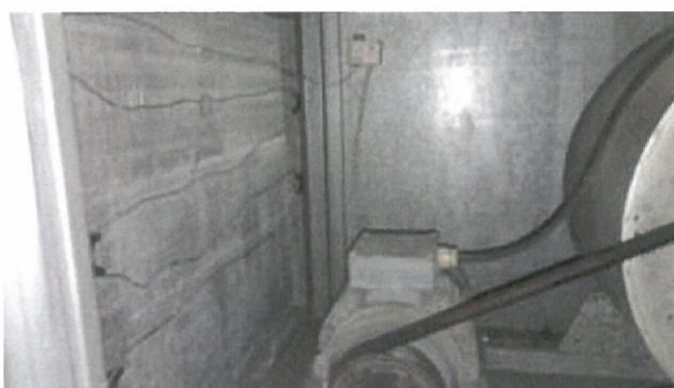
Indblæsningsventilator med varmeplade, gl. hal.jpg
