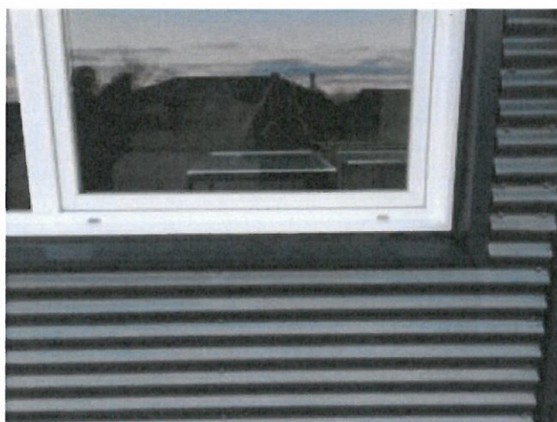
Forvitrede fugebånd omkring vindue
