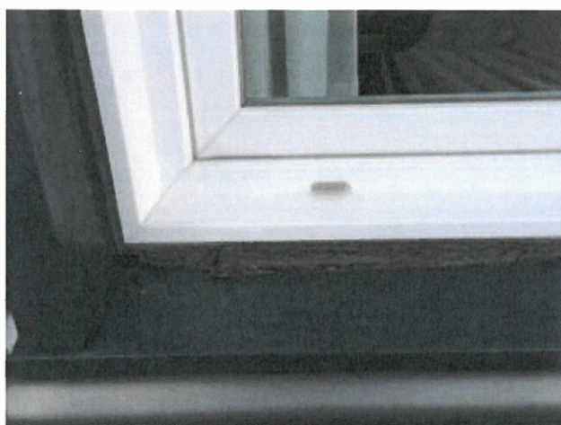
Forvitrede fugebånd omkring vindue
