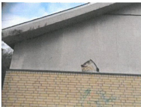
Skade på gavlbeklædning mod syd
