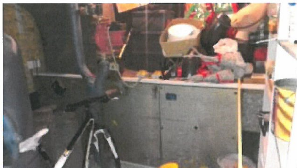
Ventilationsanlæg for hal.jpg
