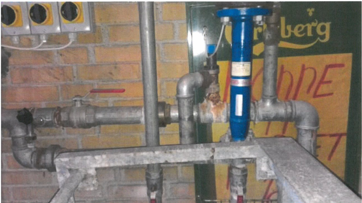
Tæring ved vandsstik.jpg
