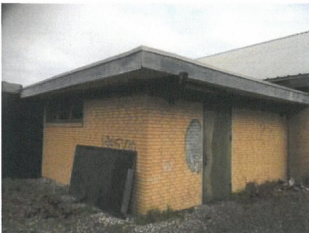
Boldrum med nedslidt eternitstern
