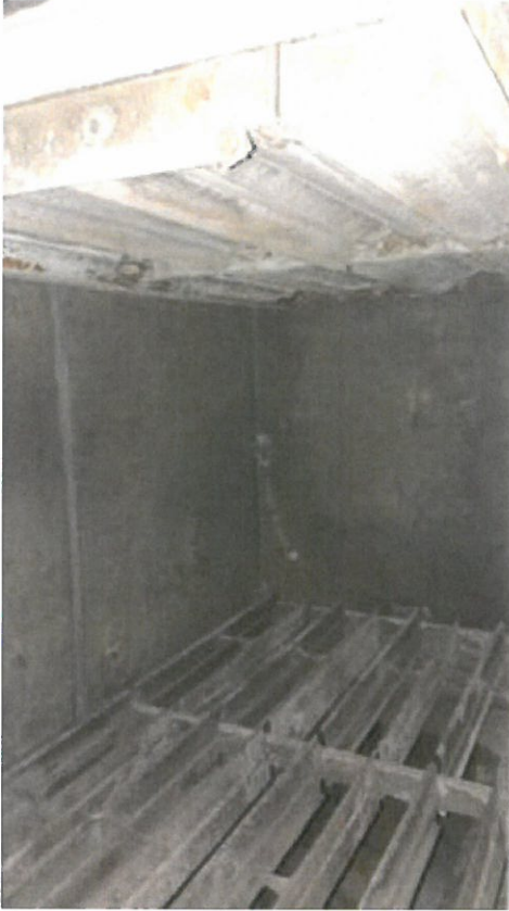
Spjæld i ventilationsanlæg.jpg
