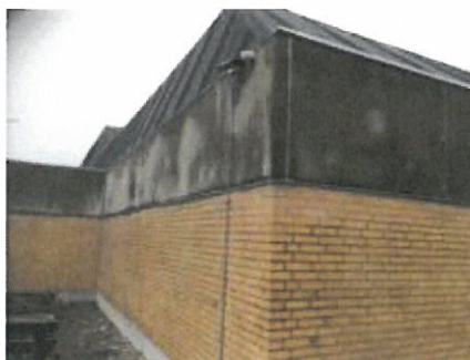
Fugeslip i elastisk fuge mellem betonelementer i facade til svømmehal
