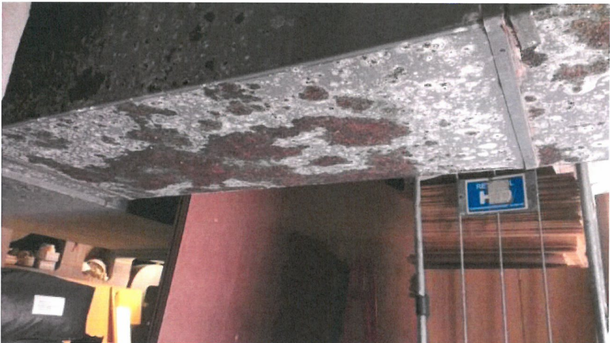
Udsugningskanal sv. hal.jpg
