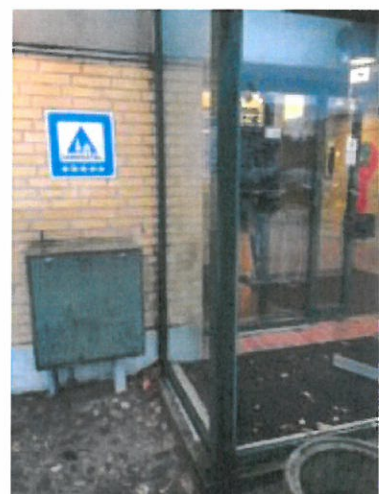
Stålrprofiler med tæring
