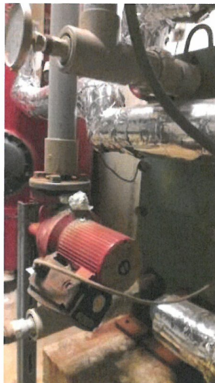
Vekslerpumpe VV bassin.jpg
