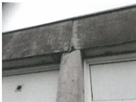
Dårlig elastisk fuge mellem betonbjælker på sidebygning til hal 1
