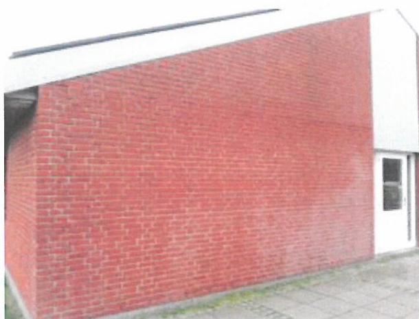
Gavl med dårlige fuger
