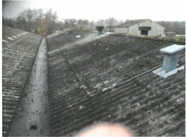
Eternitbølgeplader og skotrende mellem tagflader
