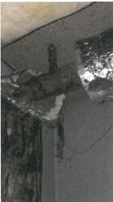
Tæring, hovedforsyning FV.jpg
