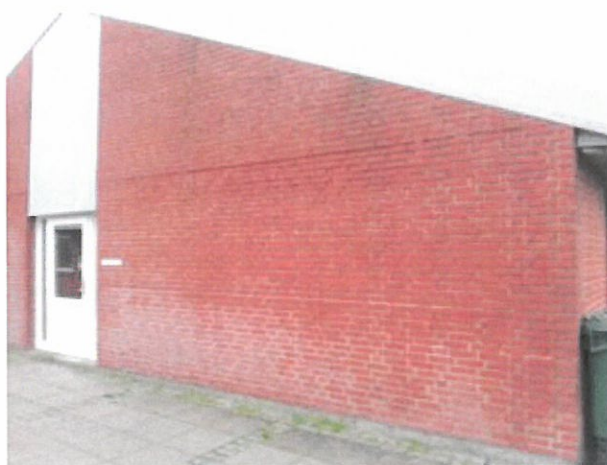
Gavl med dårlige fuger
