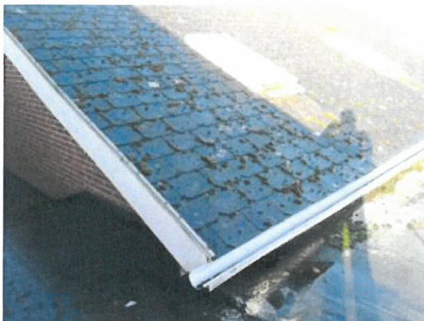
Tagdækning mod øst, med mosbegroning og algevækst
