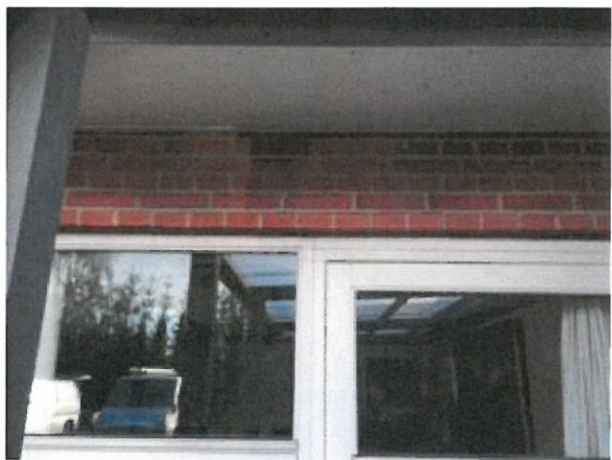
Revne i fuge mellem tegloverligger og overliggende murværk
