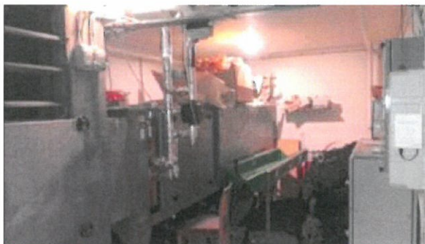
Ventilationsanlæg for hal.jpg
