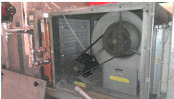
Ventilationsanlæg for hal med varmeplade.jpg
