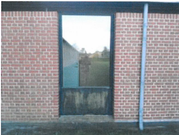
Nedslidt vinduesparti mod nord.
