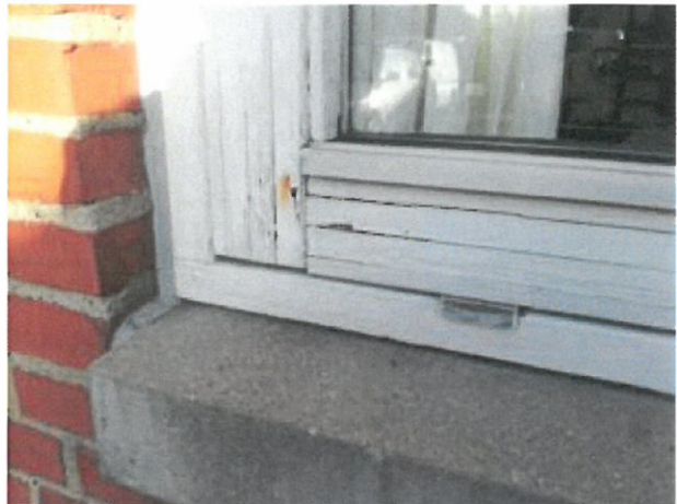
Vindue med slidt overflade og nedbrudt træværk
